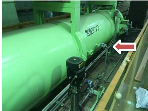
写真 4. 3. 3-1 注薬缶における加圧ポンプの液入口
