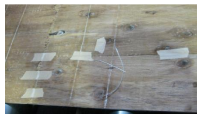
図 6.2.4.2-1 割れの補修跡
